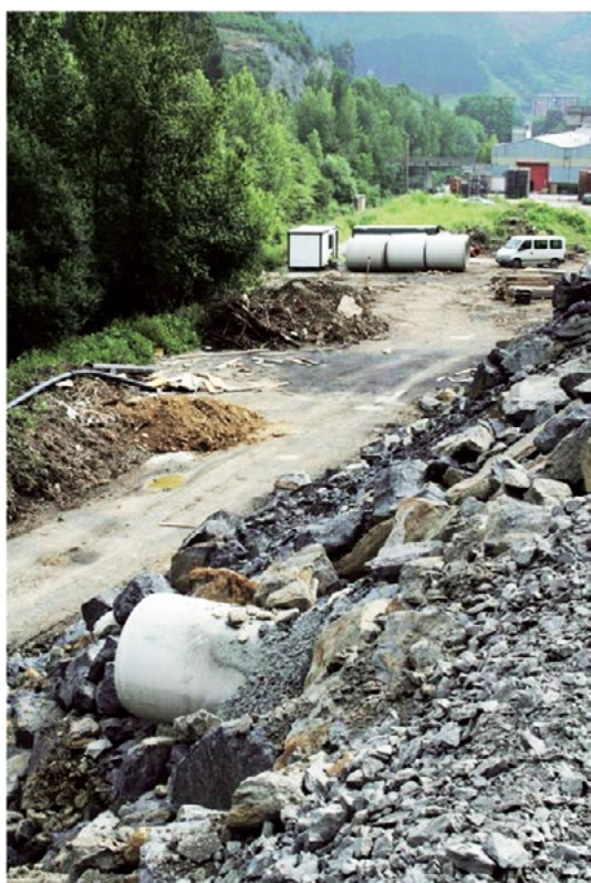
Figura 14. Destrucción de parras y vegetación circundante en la obra viaria del Corredor del Cadagua (Vizcaya).
